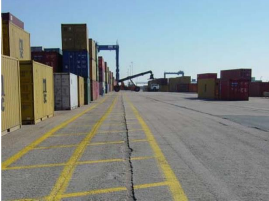
Şekil 6. Conley konteyner terminalindeki (ABD) 17 yaşındaki SSB yol kaplaması (Luhr, 2004)
