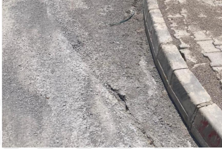
Şekil 10. SSB kaplama kenar bölgesinde iyi sıkıştırma yapılamaması sonucu meydana gelen deformasyon
