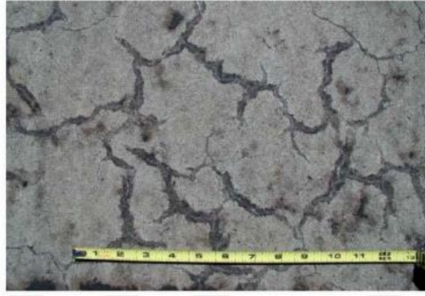
Şekil 6. Çatlaklar üzerinde görülen yüzeysel tortular
