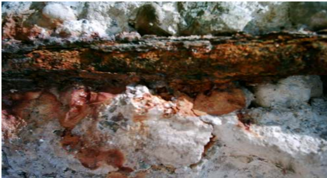
Resim 2.1. Betonarme çeliğinde korozyon
