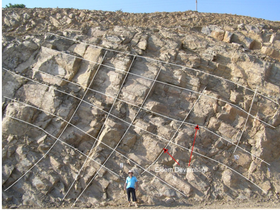
Şekil 4.5. İnceleme alanındaki silttaşlarında gözlenen eklem devamlılıkları.
