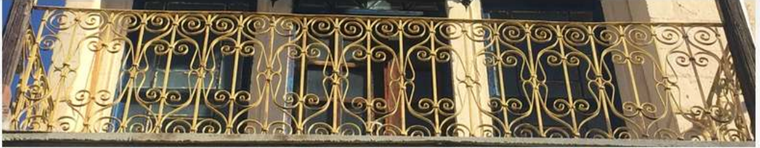
Şekil 93.B. Balkonlarda kullanılan malzeme Kaynak: Demirkol Arşivi, 2015
