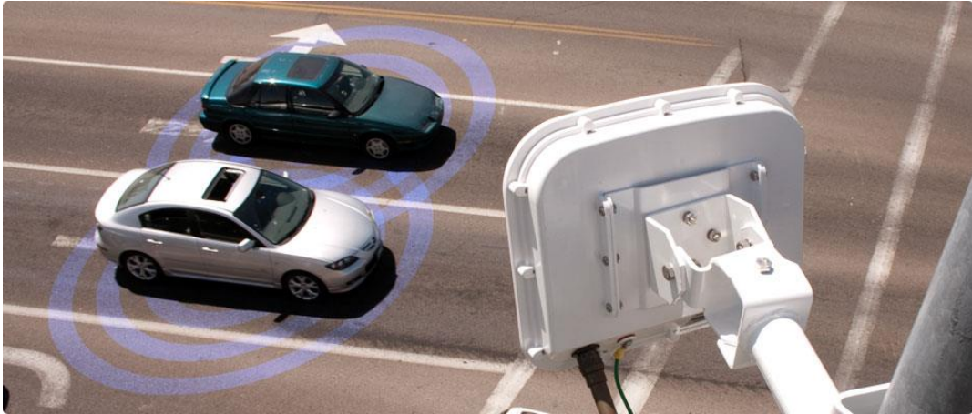
Şekil 3.11. Radar sensör kavşak uygulaması (Wavetronix, 2024)
