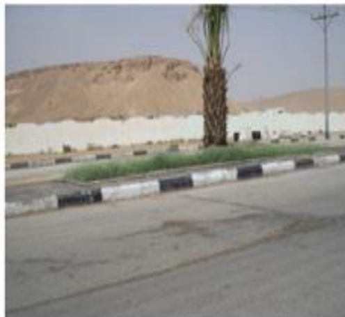
f) Green zone crack
