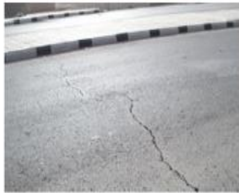
b) Transverse crack
