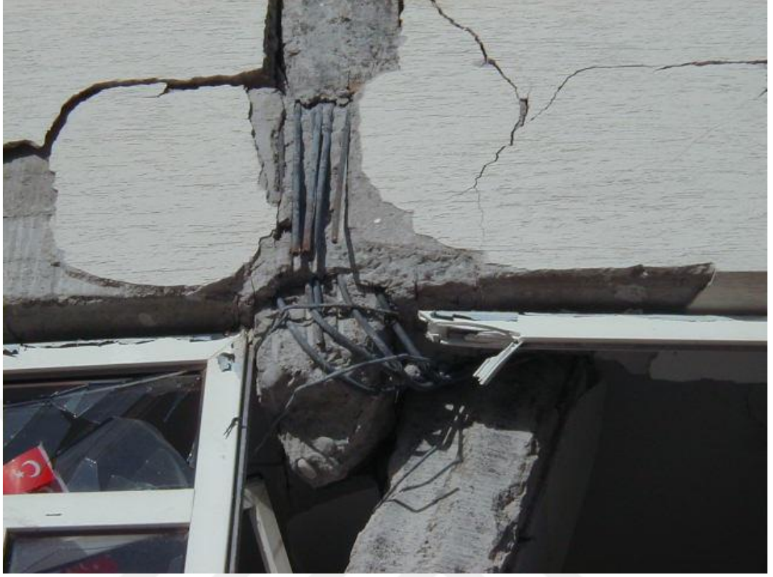
Şekil 5.6 Boyuna Donatının Hatalı Yerleşimi ve Kesme Hasarı
