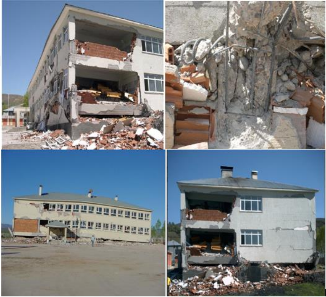
Şekil 5.3 Çeltiksuyu Köyü Yatılı İlköğretim Okulu Hasar Durumu [93]
