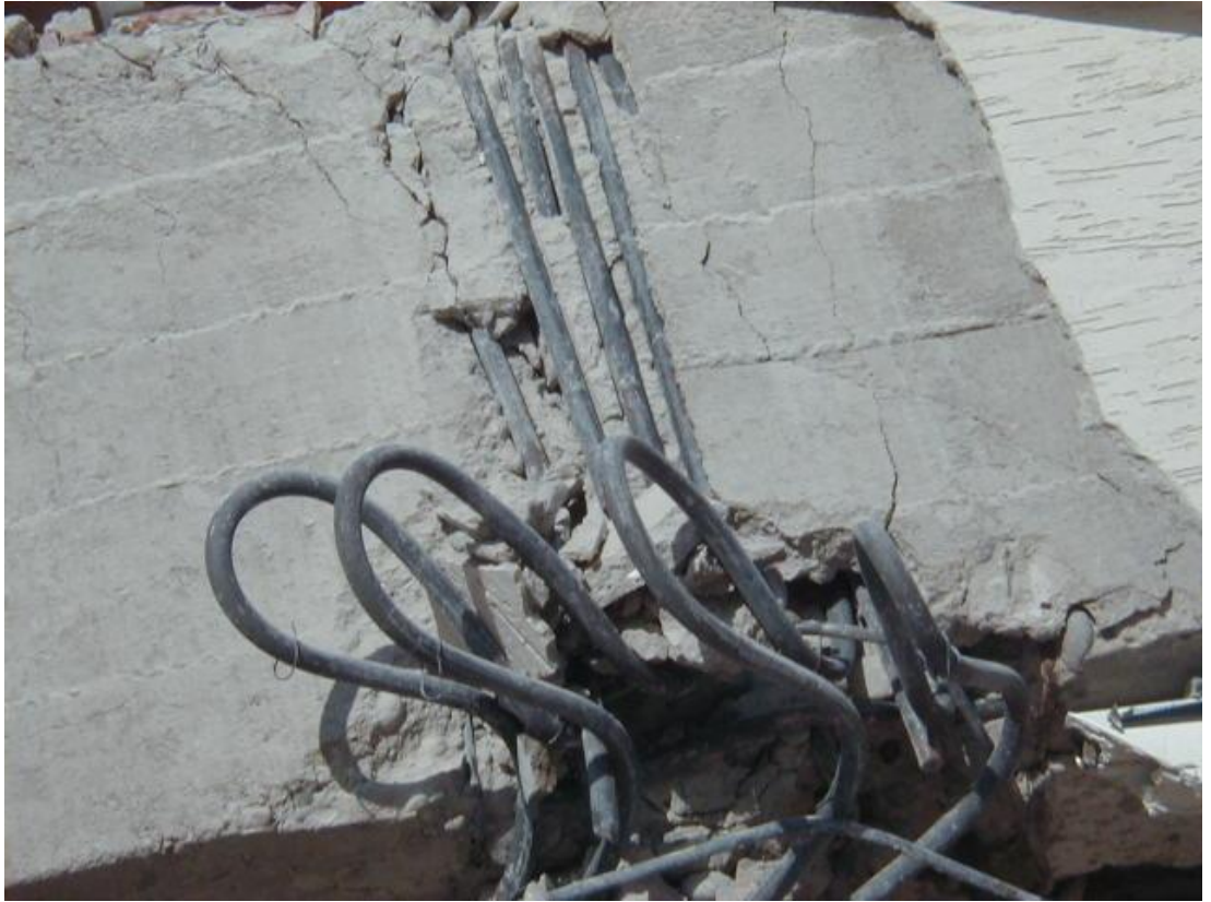
Şekil 5.11 Kolon Kiriş birleşim Bölgesinde İleri Hasar
