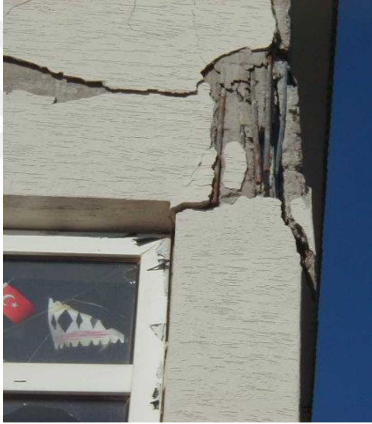
Şekil 5.5 Kolon-Kiriş Birleşim Bölgelerinde Hatalı Donatı Yerleşimi
