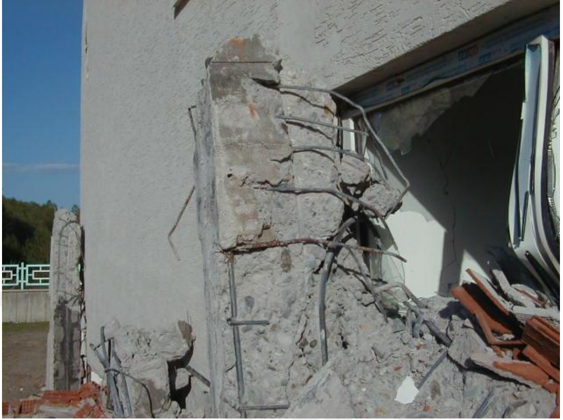
Şekil 5.8 Kolonun Birleşim Bölgesinde Sıyırılması
