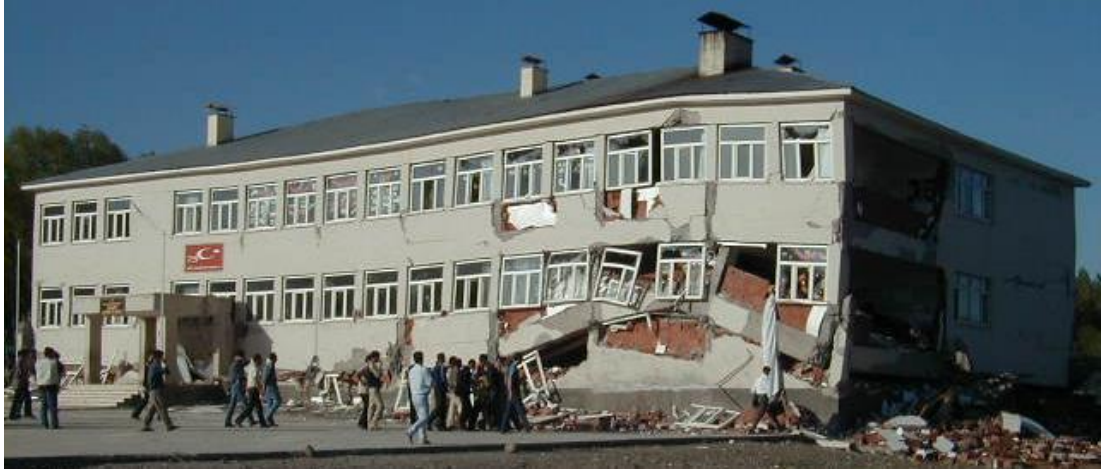
Şekil 5.4 Okul Binası Hasar Durumu
