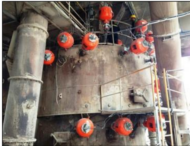
Resim 3.1 Çimento fabrikası ön-ısıtıcı kulesi hava şoku uygulaması (İnt.Kyn. 3).
