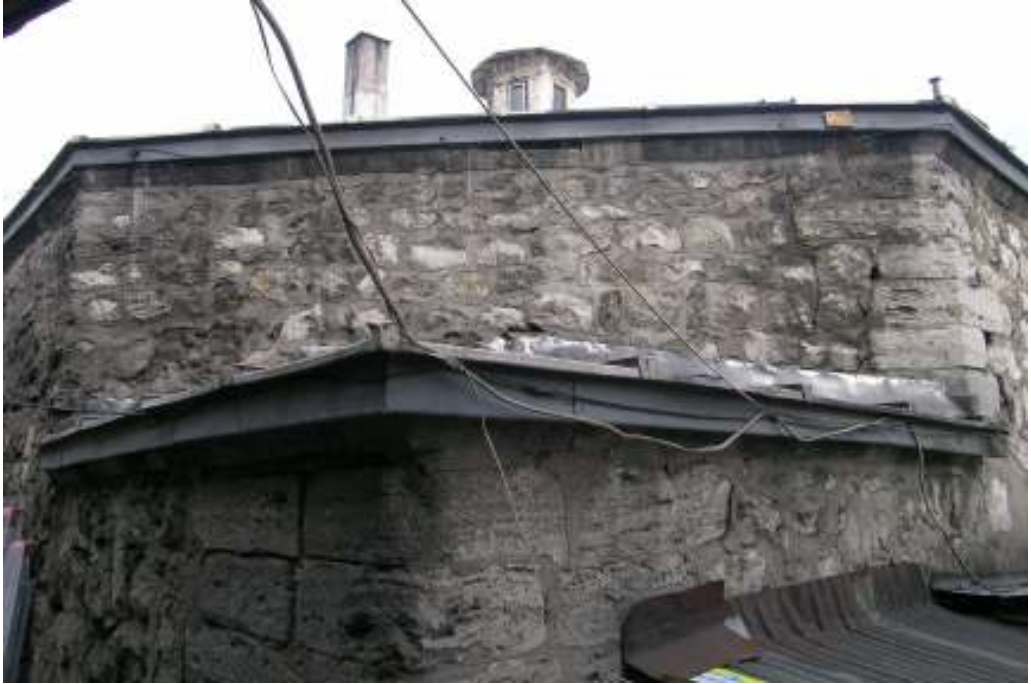
Fotoğraf:112 Meydan Hamamı, kubbe kasmağından bir detay (kuzeybatı köşe)
