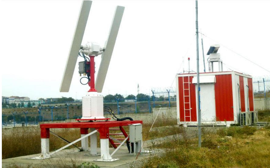
Şekil 6.1. Atatürk Havalimanı Kuş Tespit Radar Sistemi
