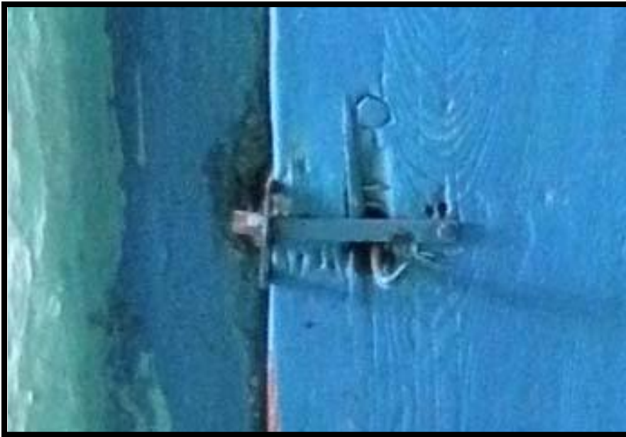
Resim 4.21. 104 oda kapısı metal eleman (Fotoğraf: O. Demberel)
