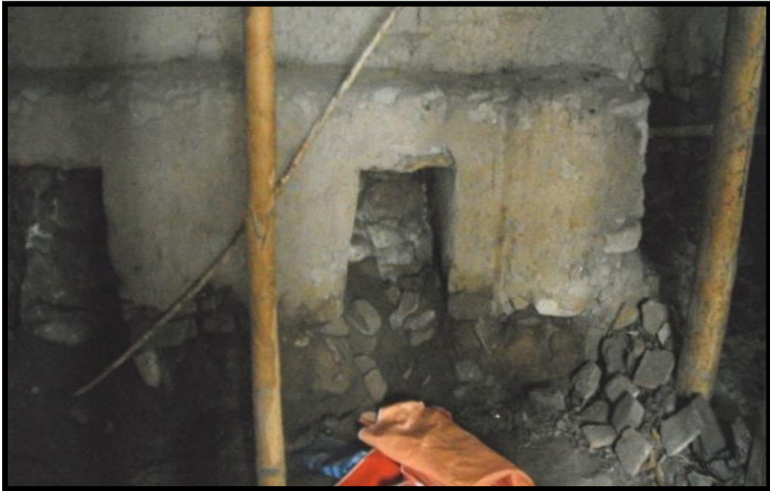
Resim 4.35. Z01 mekanında taş malzemedeki bozulmalar 1 (Fotoğraf: O. Demberel)
