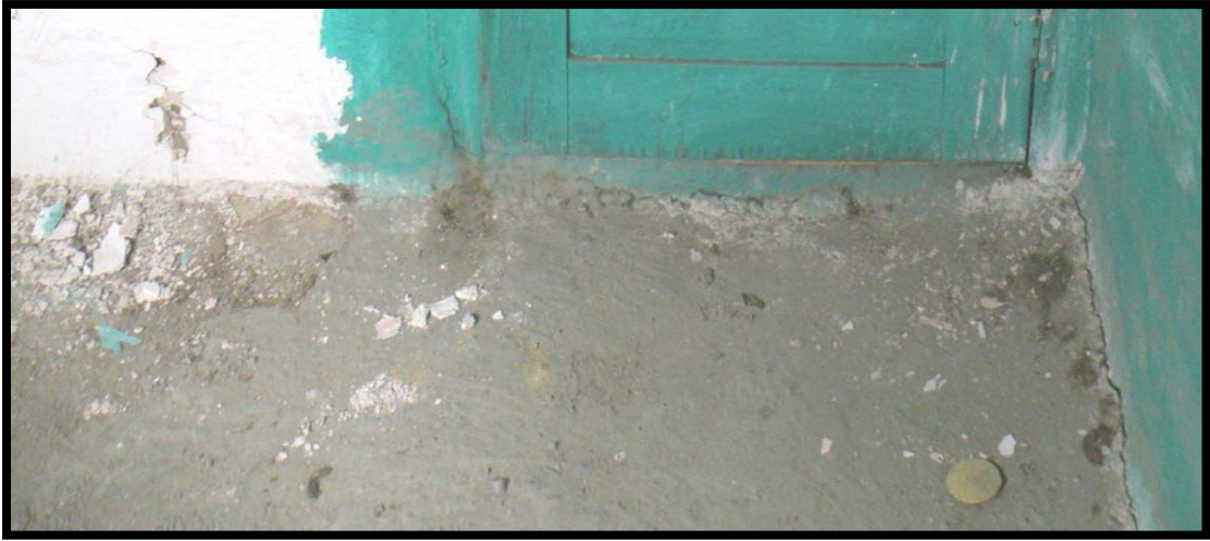
Resim 4.41. Beton şap dökülmüş zemin (Fotoğraf: O. Demberel)
