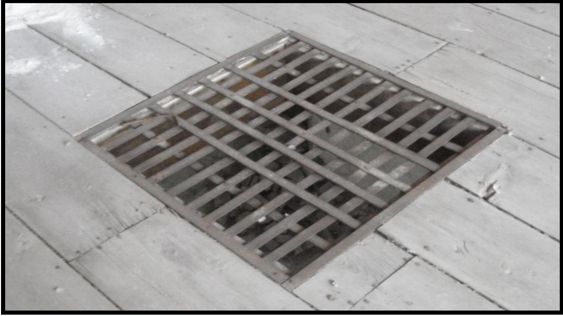
Resim 5.1. Döşemelerde yer alan açıklık (Zeyneller evi) (Fotoğraf: O. Demberel)
