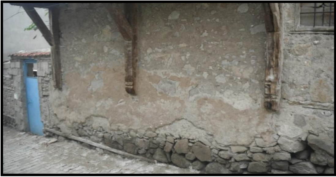
Resim 4.37. Sıva ve nemleme sorunu örnekleri (Dökülme) (Fotoğraf: O. Demberel)
