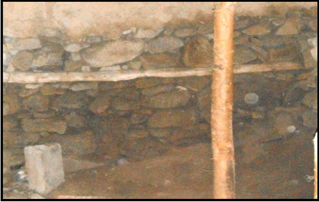
Resim 4.36. Z01 mekanında taş malzemedeki bozulmalar 2 (Fotoğraf: O. Demberel)
