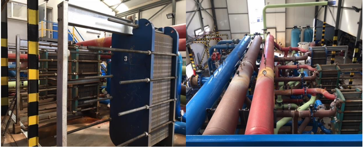
Şekil 2-3: Jeotermal ısı merkezinden görünüm
