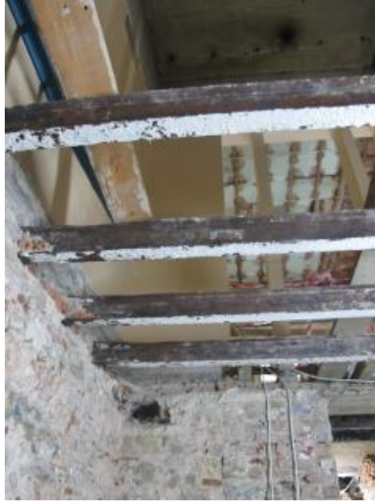
Şekil 4.85: Volta döşemelerdeki korozyon (Yeteroğlu, E. 2014)
