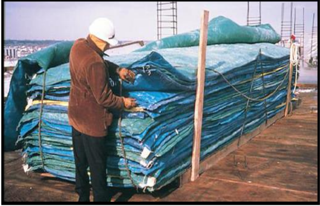
Şekil 4.2: Elektrikli ısıtma battaniyelerinin depolanması.
