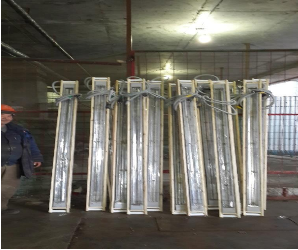
Şekil 6.3: Ahşap kılıf içerisinde kızıl ötesi ısıma cihazları (infraredler).
