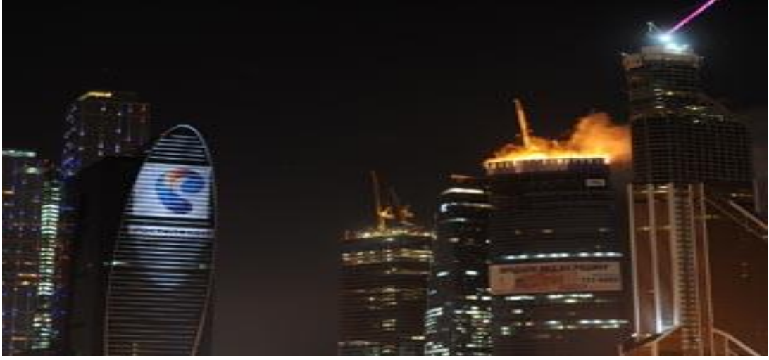
Şekil 6.2: Beton ısıtılırken meydana gelen bir yangın görüntüsü-2, Moskova (2012).
