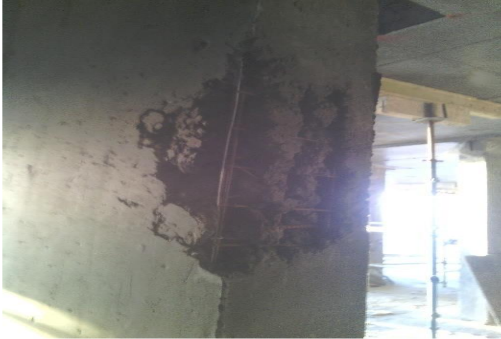
Şekil 6.4: Beton kalite problemi örneği.
