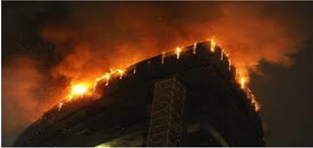
Şekil 6.1: Beton ısıtılırken meydana gelen bir yangın görüntüsü-1, Moskova (2012).
