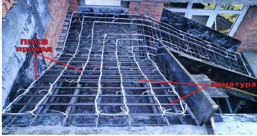
Resim 2.4 Kablo döşeme sistemi ile ısıtma.
