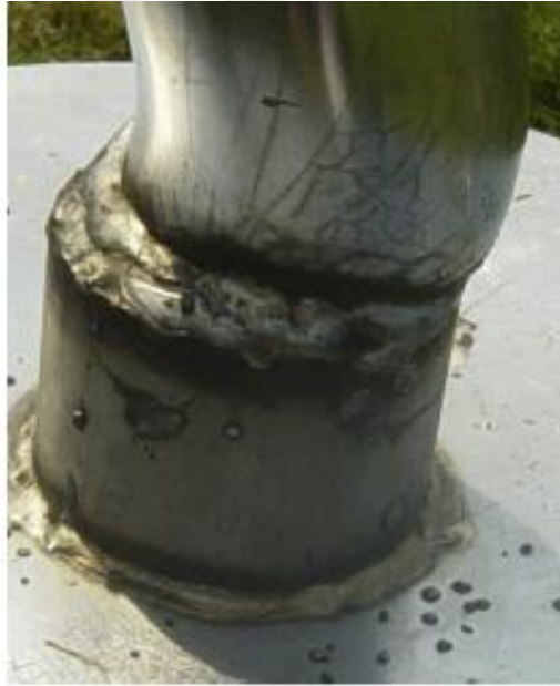
Şekil 2.7. Paslanmaz Çeliğin Gerilme Korozyonu Çatlaması (Popov 2015)
