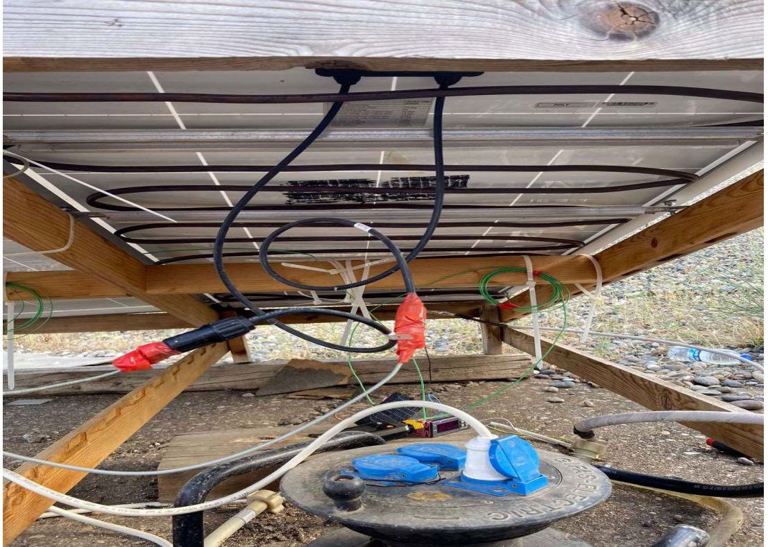
Şekil 5.13 Kurulumu Yapılan Panellerin Alttan Görünümü
