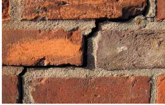
řekil 5-3 Kire Harlı Duvar Hasarı
