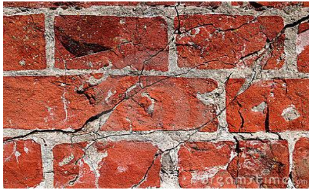
řekil 5-4 imento Harlı Duvar Hasarı
