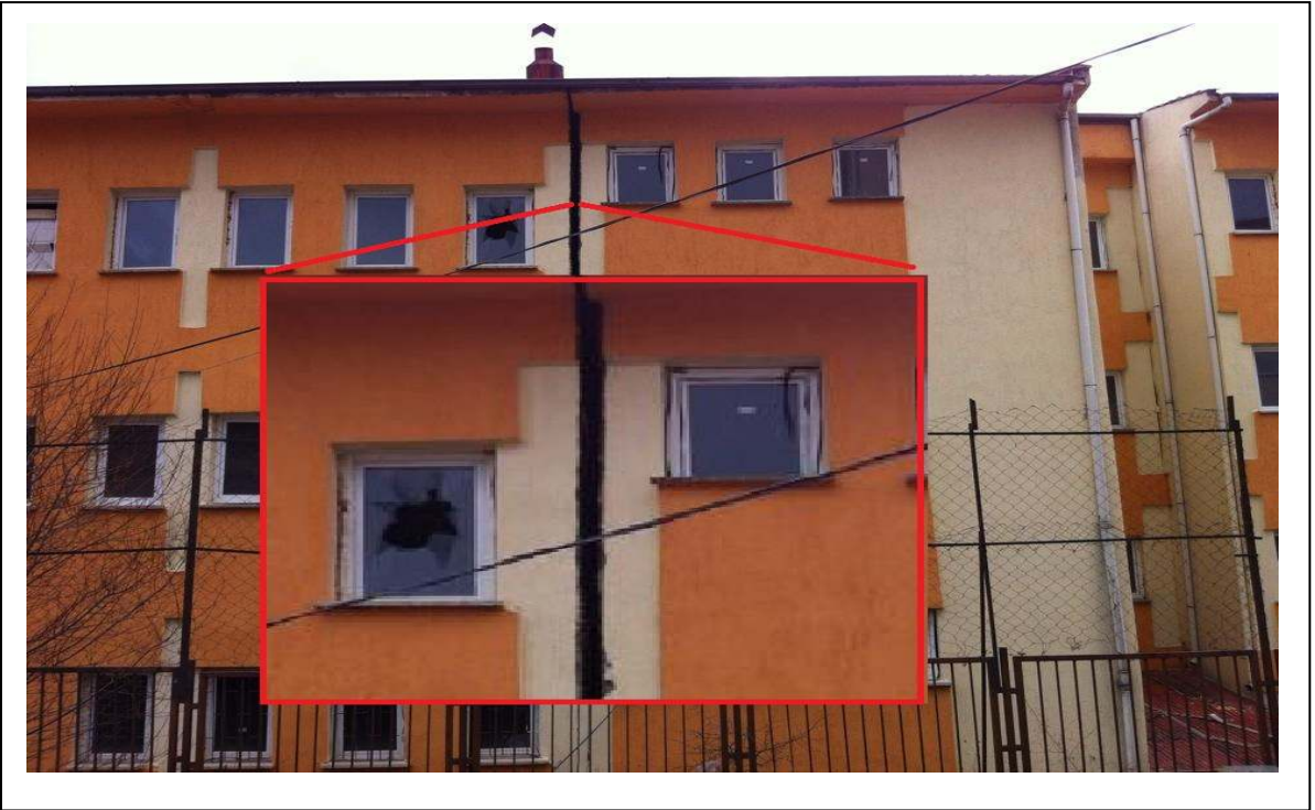
Şekil 5.6. İmam Hatip Lisesi duvarlarındaki hasarlar
