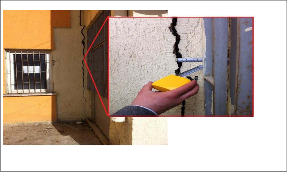
Şekil 5.5. İmam Hatip Lisesi duvarlarındaki hasarlar
