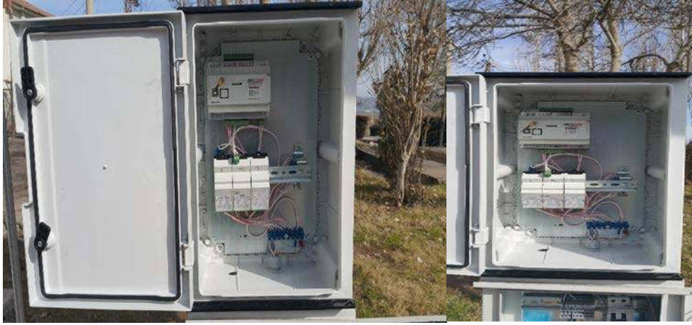
Şekil 4.35. SMGTS scada panosu
