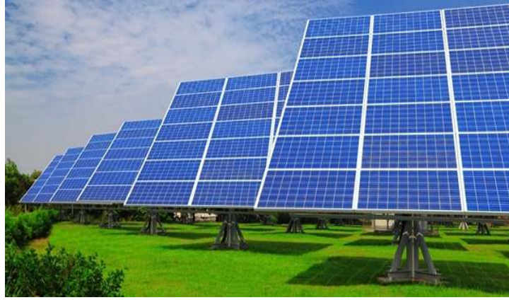
Şekil 2.22. Güneş takip sistemi uygulaması
