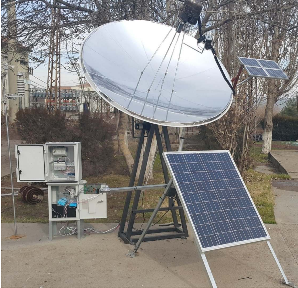
Şekil 6. SMGTS'ye ait kurulumu tamamlanmış sistem görünümü
