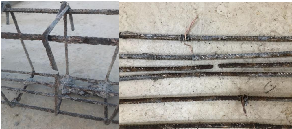
Şekil 4.27. Korozyona maruz kalmış donatılarda kopmalar
