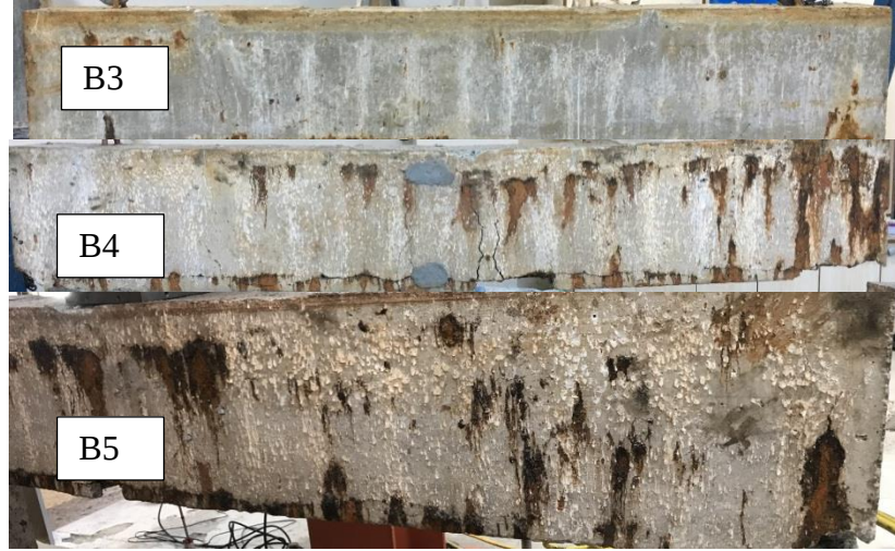
Şekil 4.31. Korozyona maruz kalmış kirişler
