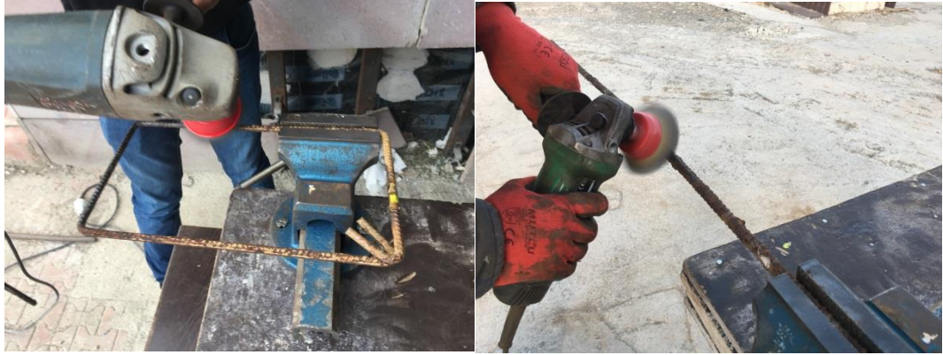
Şekil 4.25. Betonarme kiriş içerisinden çıkarılıp mekanik temizleme yapılan donatılar
