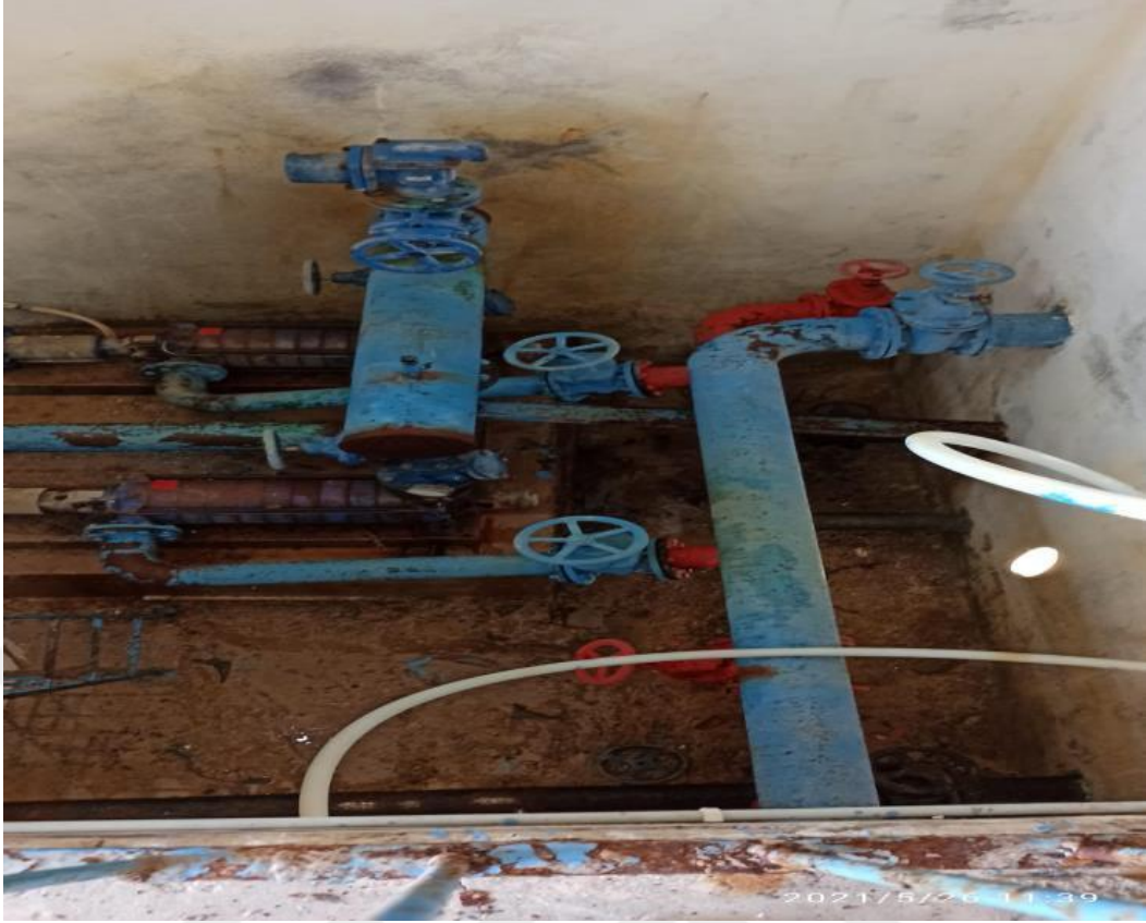
Şekil 4.10.Cezaevi su deposu manevra odası
