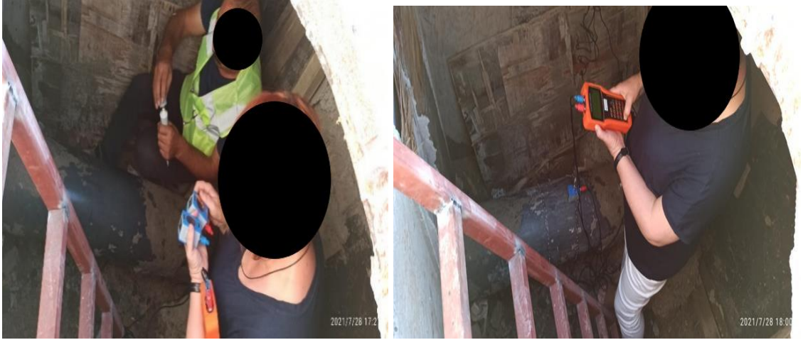
Şekil 4.16.DMA-1 Ultrasonic Portatif Debimetre Montajı
