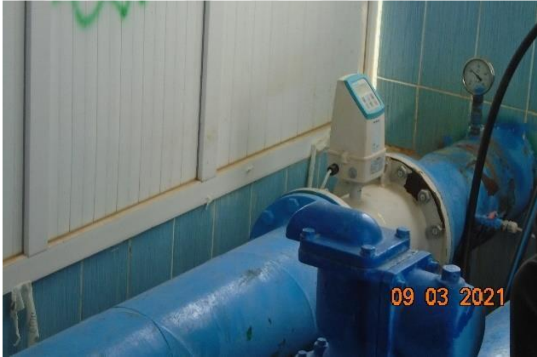
Şekil 4.7.Cezaevi deposu elektro manyetik debimetre
