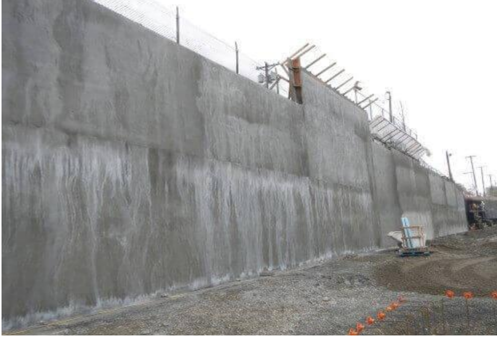
Şekil 2.6. Betonarme perdede meydana gelen çiçeklenme (URL-5,2018).
