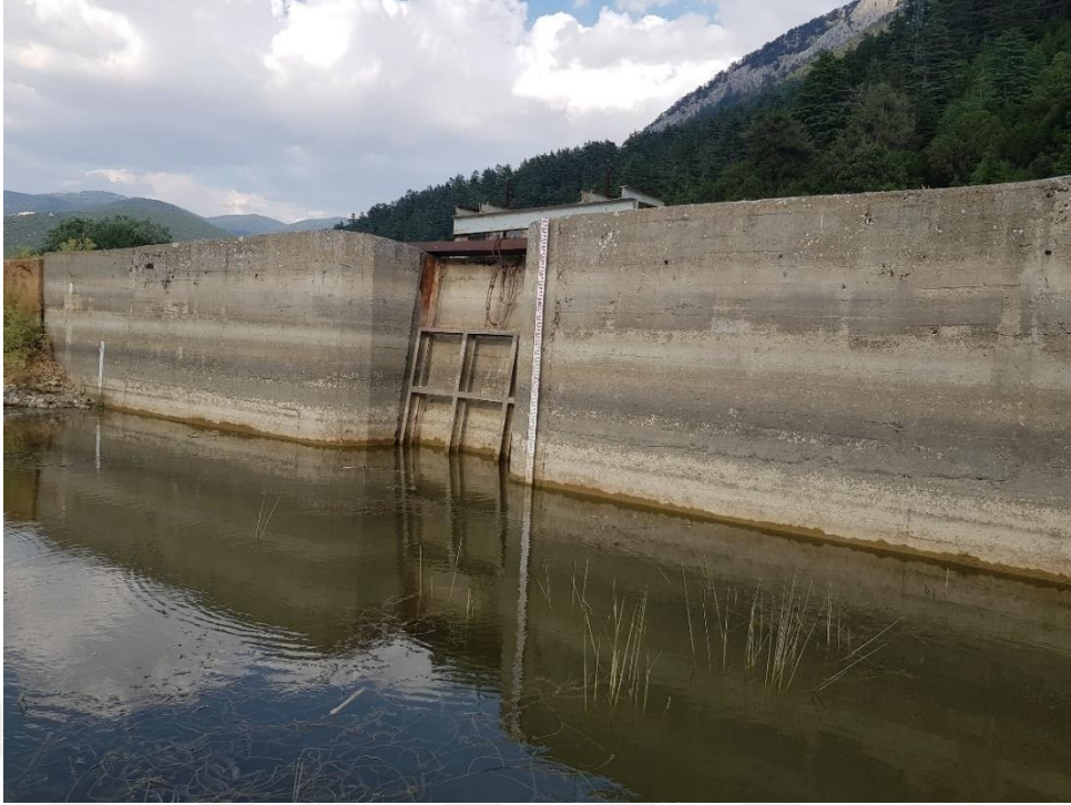
Fotoğraf 4.9: Avlan Gölü'nün Güneyinde Yer Alan Kanal Kapağı. Yaz mevsiminde yağış azlığı ve düdenlerde meydana gelen sızıntılardan dolayı göl içerisindeki su seviyesi azalmaktadır. Kış aylarında göl içerisindeki su seviyesinin artmasına bağlı olarak sel ve taşkınları önlenmek için belirli aralıklarla kanal kapağı açılmaktadır.
