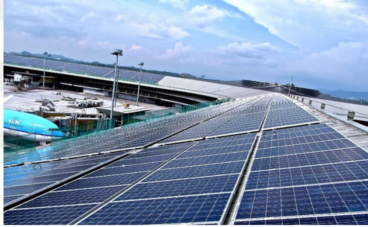
Şekil 2.2. Kuala Lumpur Havalimanı Güneş Enerjisi Santrali (http-2).
