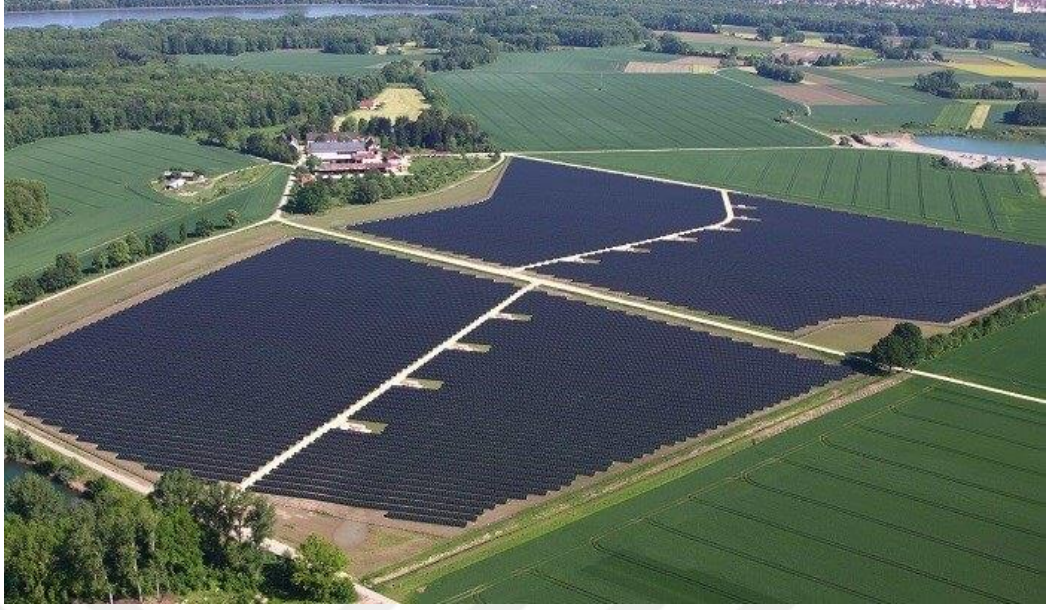
Şekil 8.3: Güneş Enerjisi Panel Örneği ( https://www.muhendisbeyinler.net , 2016)
