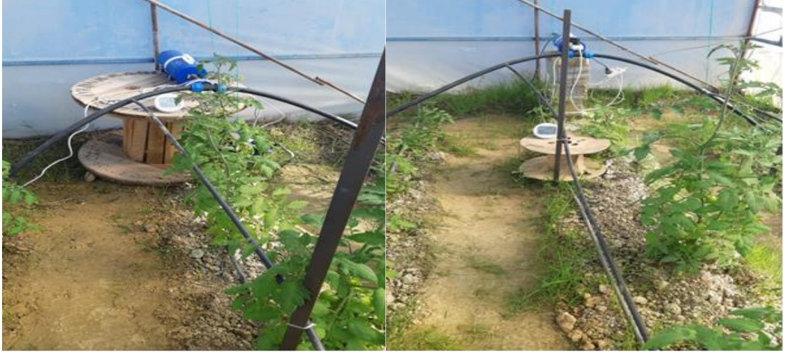
Şekil 3.20. CO 2 gazının sera içinde dağıtım hattı ile dağıtılması
