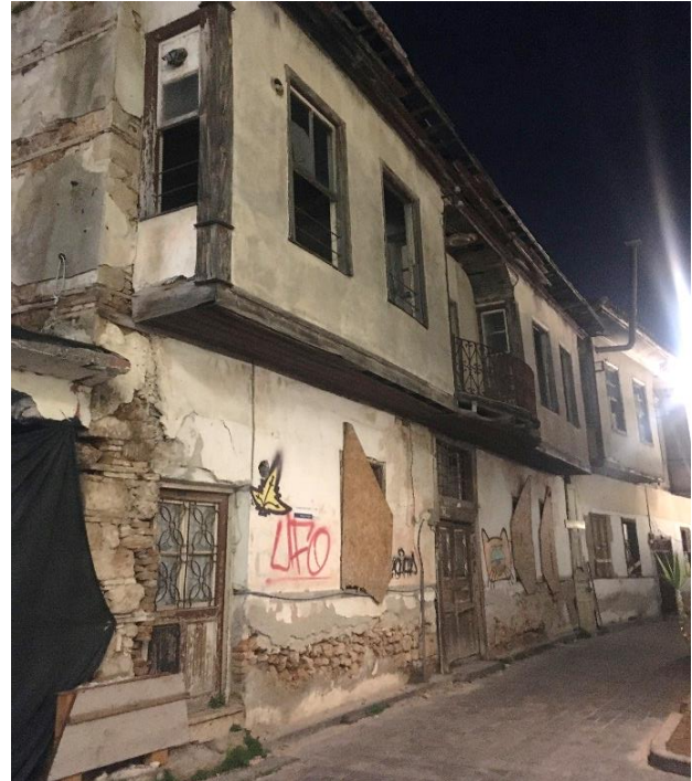
Fotoğraf 3. 11. Kocatepe Geçiti Sokak'taki Metruk Yapı
