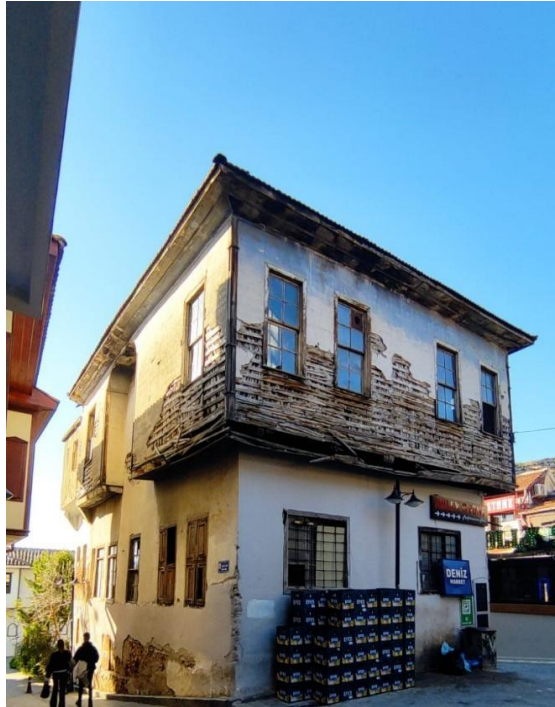
Fotoğraf 3. 10. Musalla Sokak'taki Metruk Yapı
