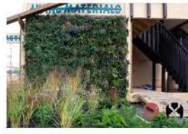
AŞIRI BÜYÜMÜŞ DUVAR
