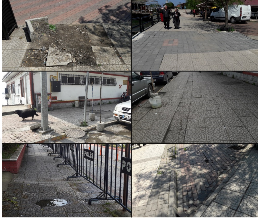
Şekil 4. 99: Zarar görmüş ve onarılmamış döşemeler (Şahin, 2022).
