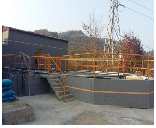
Resim 2. Atıksu Arıtma Tesisi
