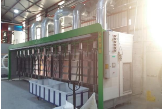
Resim 3. Tesisin İç Görünüşü (Üretim Sahası)
