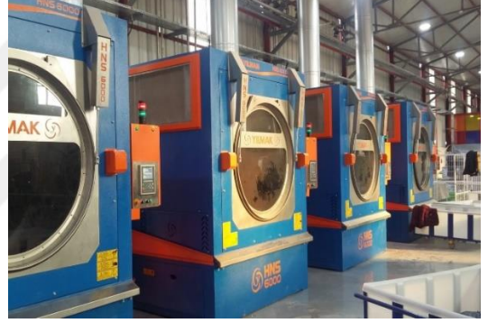
Resim 4. Tesisin İç Görünüşü (Üretim Sahası)
