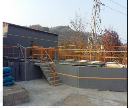
Resim 2. Atıksu Arıtma Tesisi
