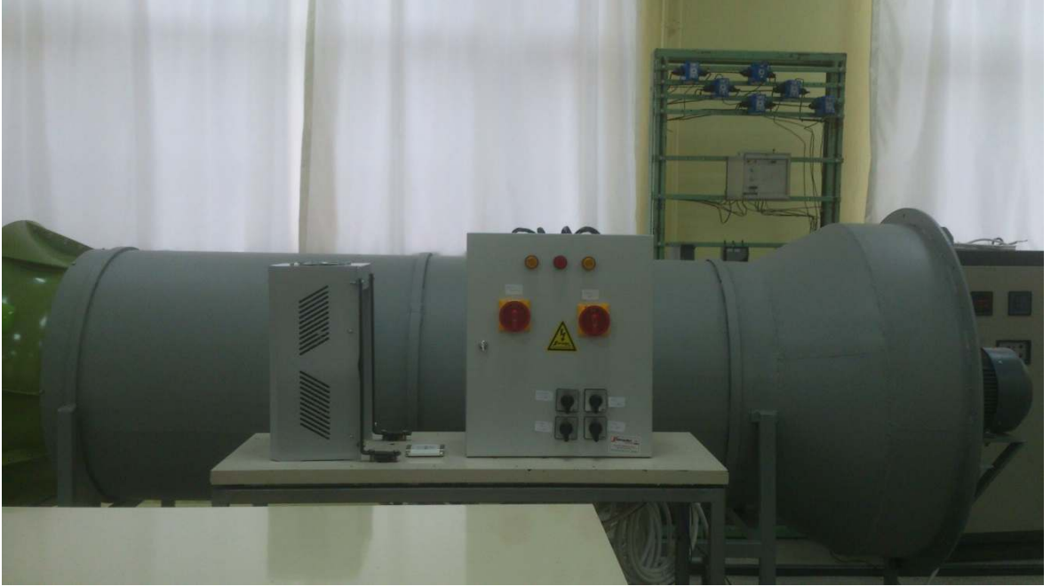
Resim 6-3. Hava kanalı ve elektrik pano görüntüsü
