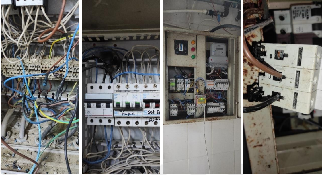
Şekil 4.51. ISUBÜ SIST, SSM ve SST elektrik panoları sorunları
