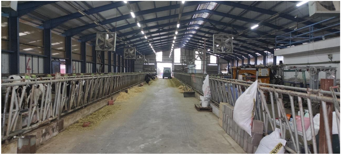
Şekil 3.10. MAKÜ işletmesi, hayvan serinletme fanları
