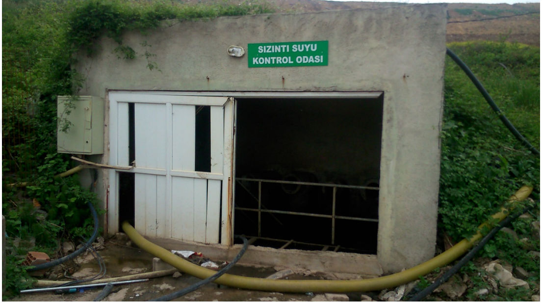
Şekil 3.1. Samsun Katı Atık Düzenli Depolama Sahası sızıntı kontrol odası
