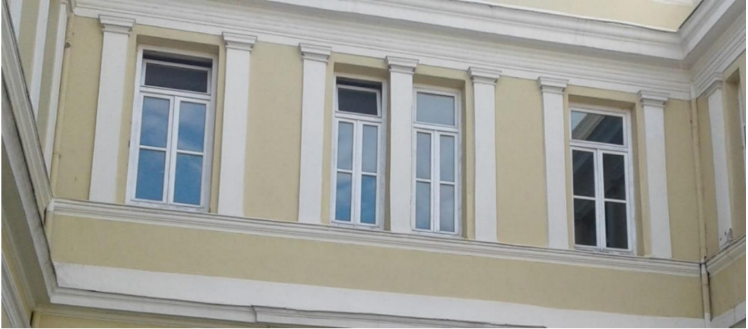
Fotoğraf 141 Atatürk Lisesi Kuzey ve Güney Cephede Yer Alan Silmeler ve Pilastrlar
