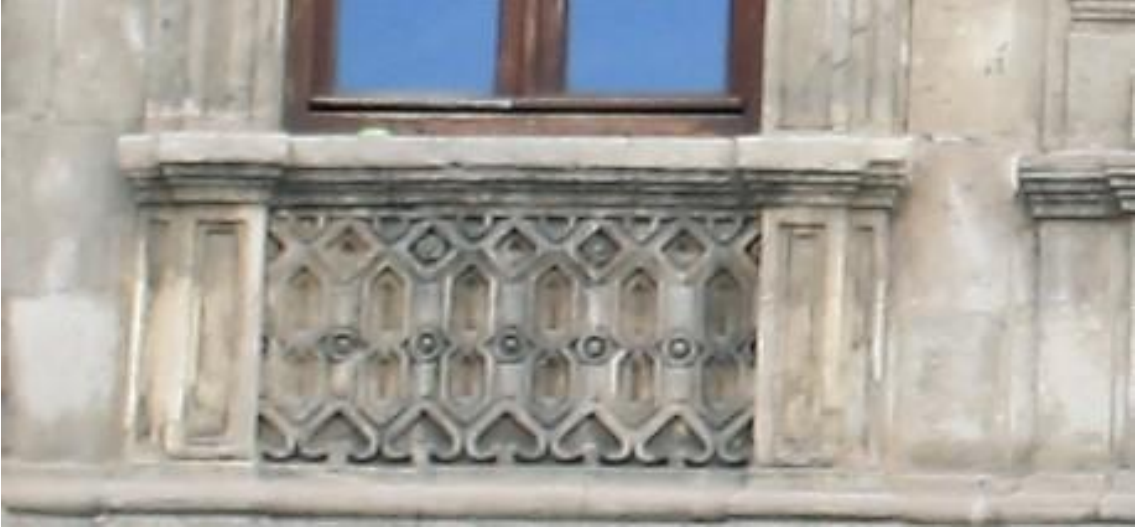
Fotoğraf 82 Mithatpaşa Mesleki ve Teknik Anadolu Lisesi Kuzey Cephede Yer Alan Üst Kat Pencerelelerinden Ortadan Bulunan Üç Tanesinin Alt Tarafında Bulunan Süslemeler
