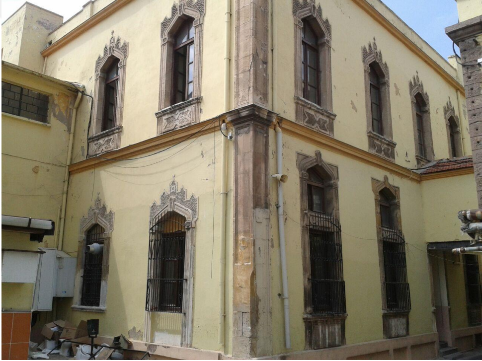
Fotoğraf 74 Mithatpaşa Mesleki ve Teknik Anadolu Lisesi Güney ve Doğu Cephedeki Alt Kat Pencerelelerinin Alt Tarafındaki Düşen Süslemeler
