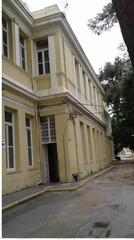
Fotoğraf 136 Atatürk Lisesi Güney Cephede Taşıntı Yapan Bölümde Yer Alan Kapı ve Pencereleler
