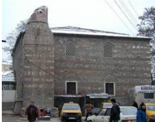
Şekil 90. Minare gövdesinde oluşan hasar örneği (Doğangün vd., 2008, s. 507 ).
