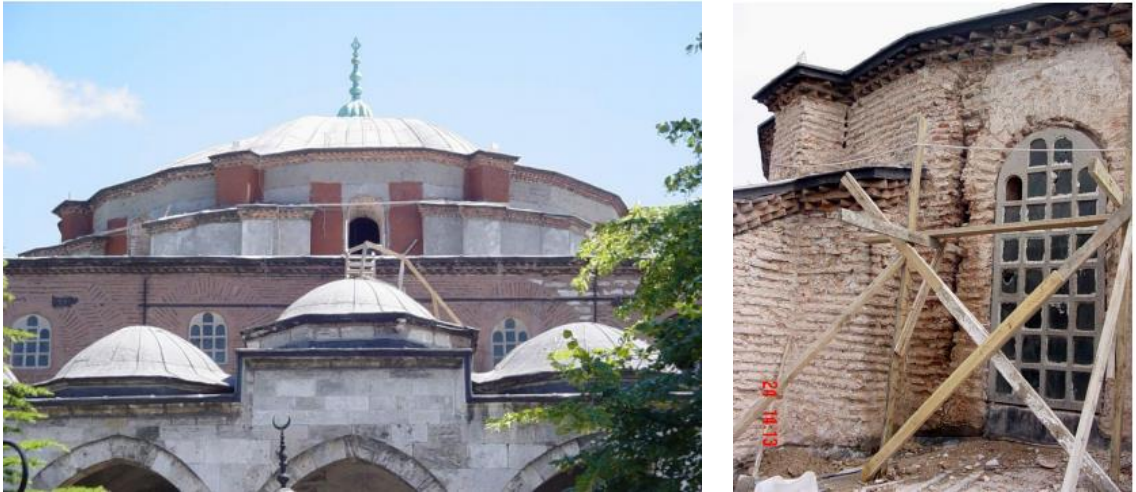
Şekil 1.43. Küçük Ayasofya Caminde oluşan kubbe kasnağındaki hasarlar (Aköz, 2008).
