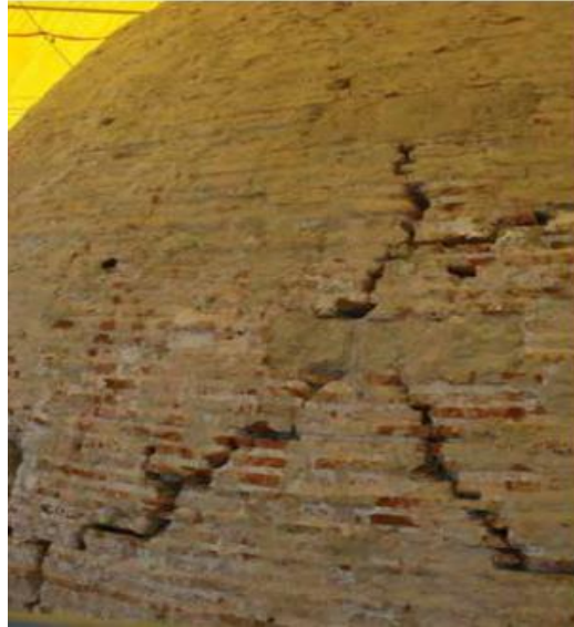
Şekil 1.29. Cami kubbesinde meydana gelen diyagonal çatlaklar (BASF, 2018).
