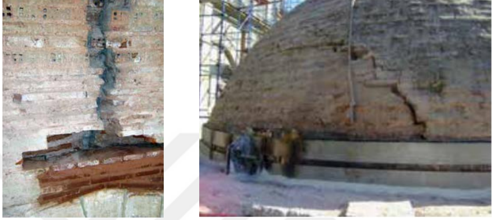
Şekil 1.40. I. Mahmut kütüphane kubbesindeki çatlakların çekme çemberi uygulaması (Çılı ve Yıldız, 2013).
