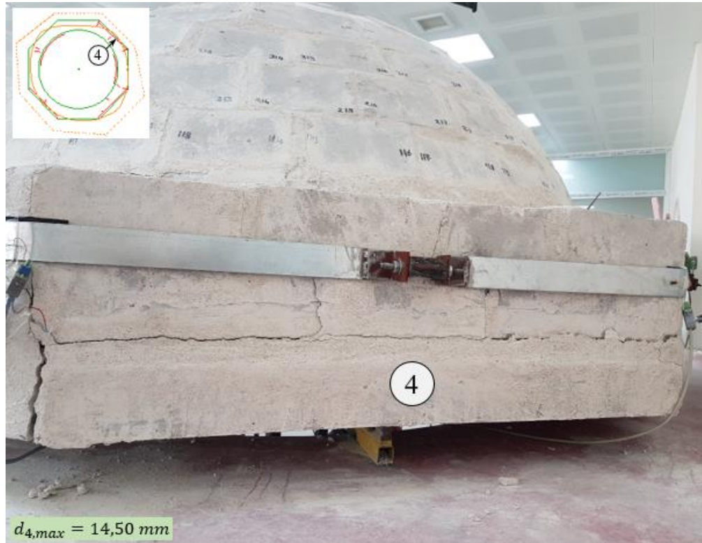
Şekil 4.99. ERD numunesinin 4. kol üzerinde oluşan çatlaklar.
