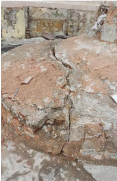
Şekil 3. 4. Kubbede oluşan yapısal çatlağın dış cephe görünümü (VGM arşivi)
