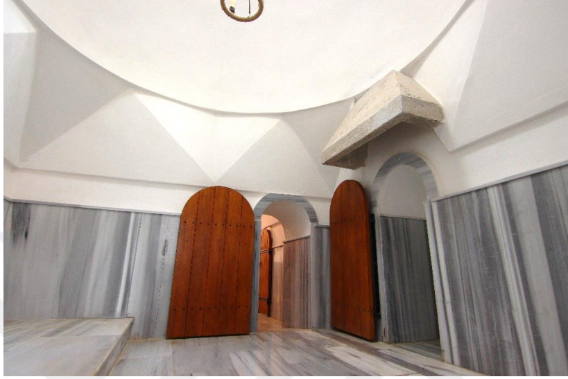
Şekil 3. 29. Ilıklıktan sıcaklığa ve WC/duş bölümlerine geçiş kapıları
