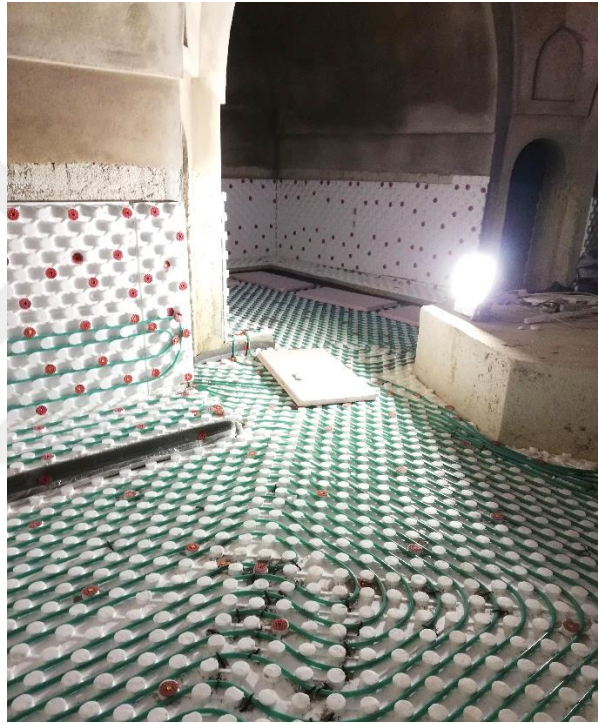
řekil 3. 34.Hamamın yerden ısıtma sistemi
