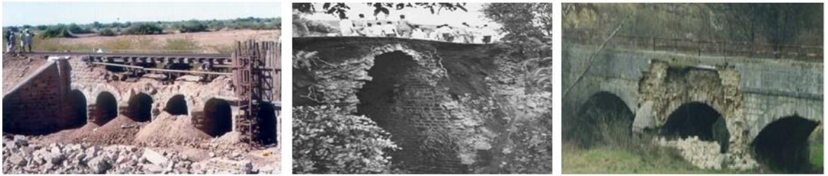
Şekil 32: Deprem sonrası yan duvarların göçmesi. (Rota, 2004).
