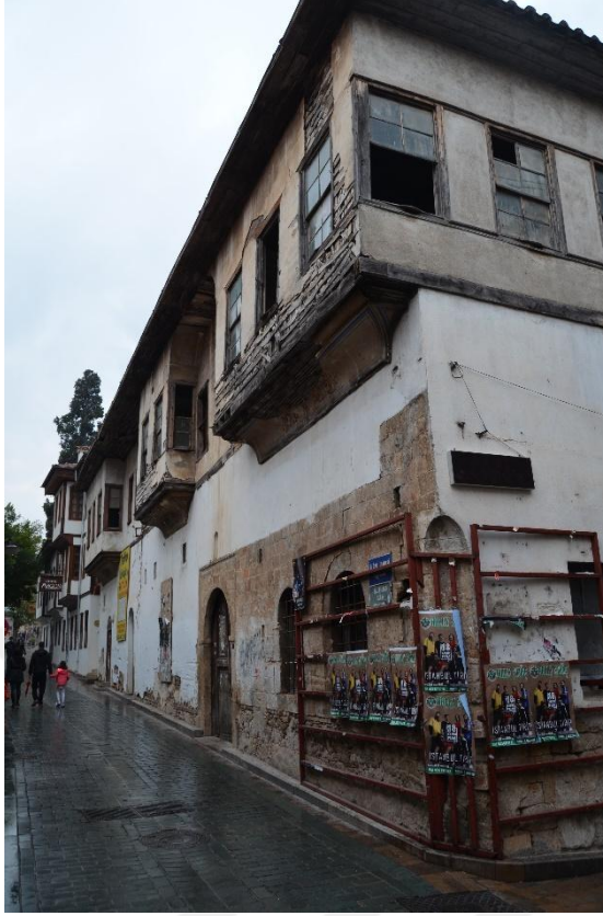
Şekil 4.17. Bakımsız ve eski bir yapı örneği (Orişinal 2018)
