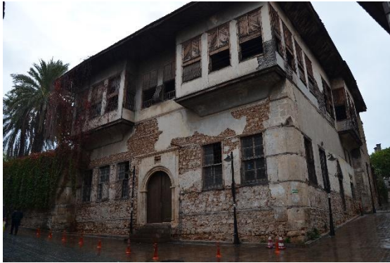
Şekil 4.15. Bakımsız ve eski bir yapı örneği (Orijinal 2018)
