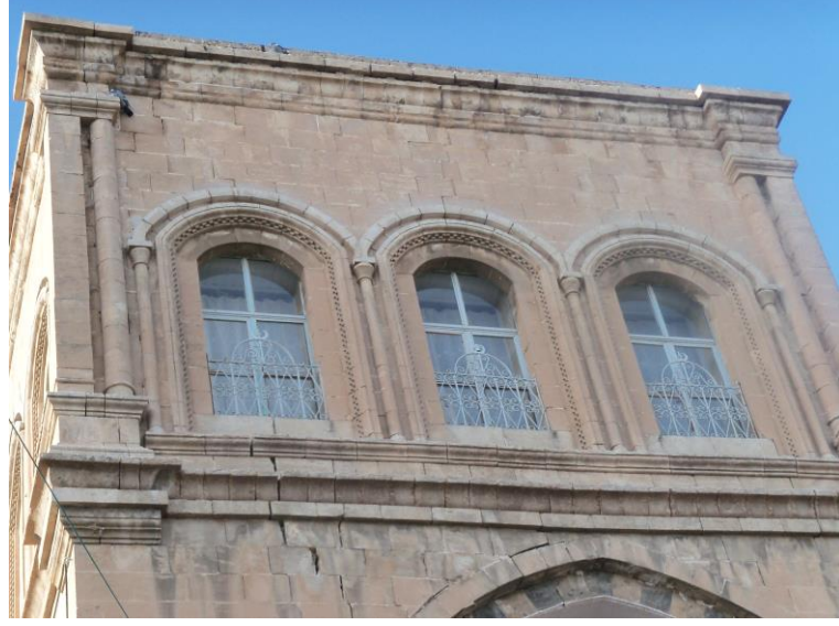
Şekil 2.16. Çift cidarlı yığma yapı binada duvar çatlaması (Mungan, 2020)
