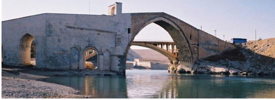
Şekil Ek 2.20. Köprüde 1985 yılında yapılan onarım (KGM, 2009)
