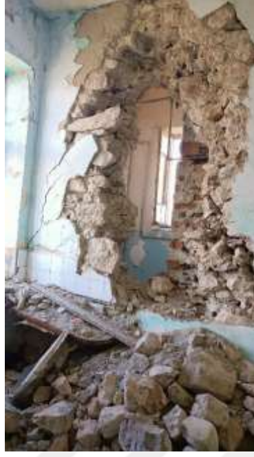
Şekil 5.5. Zemin katta mutfak-wc arasındaki duvara verilen tahribat
