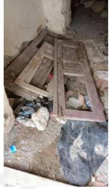
Şekil 5.6. Yapının kapılarının sökülüp atılmasına örnek
