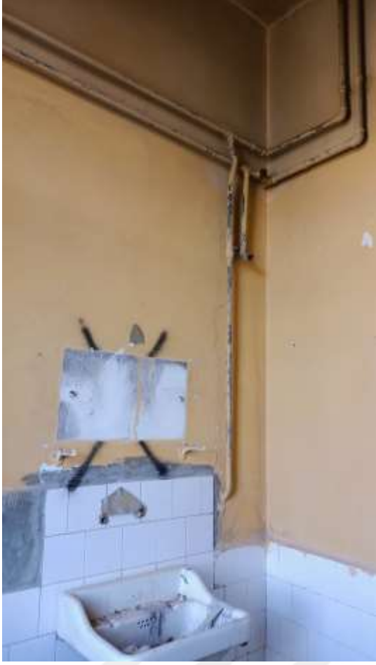
Şekil 4.9. Konağın temiz su tesisatı boruları
