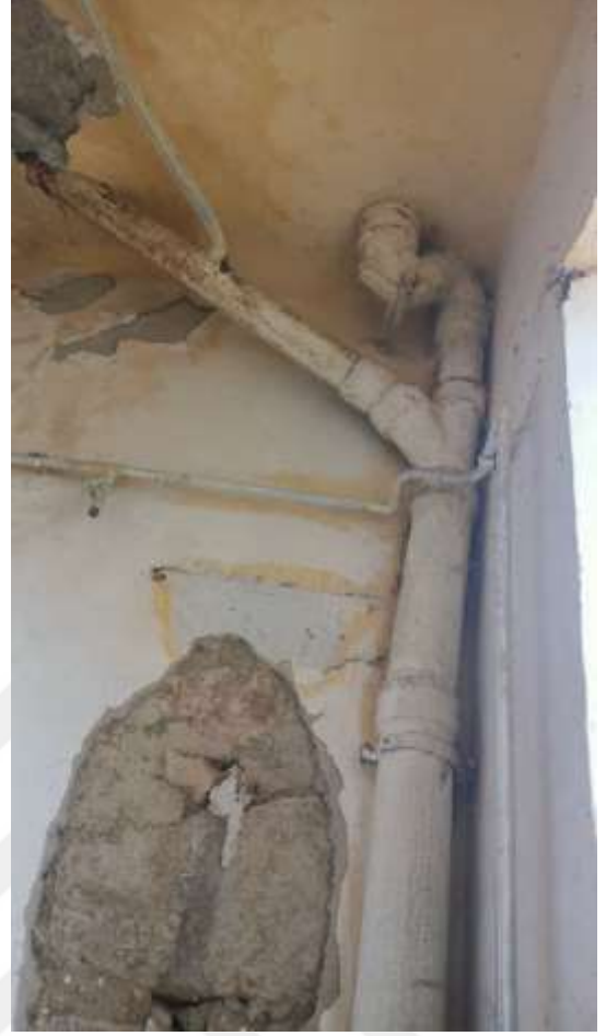
Şekil 4.10. Konağın pis su tesisatı boruları
