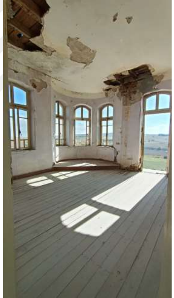
Şekil 5.2. Çatıdaki çökmeler sebebiyle yapının içerisindeki hasar
