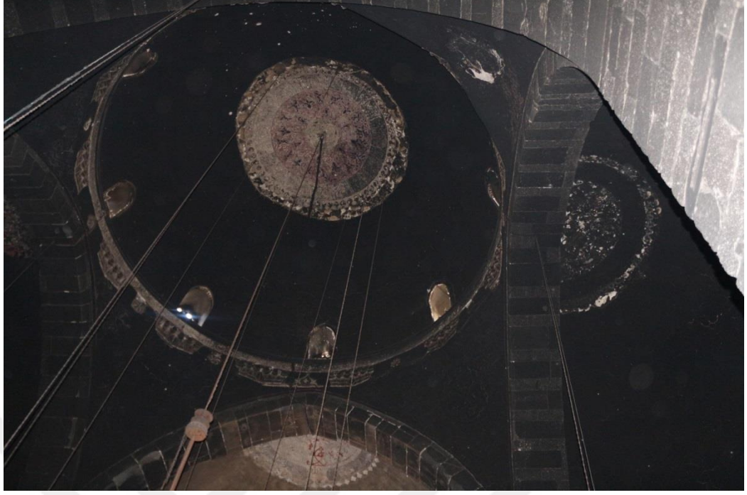
Şekil 7.10. Yangından sonra restorasyon öncesi
