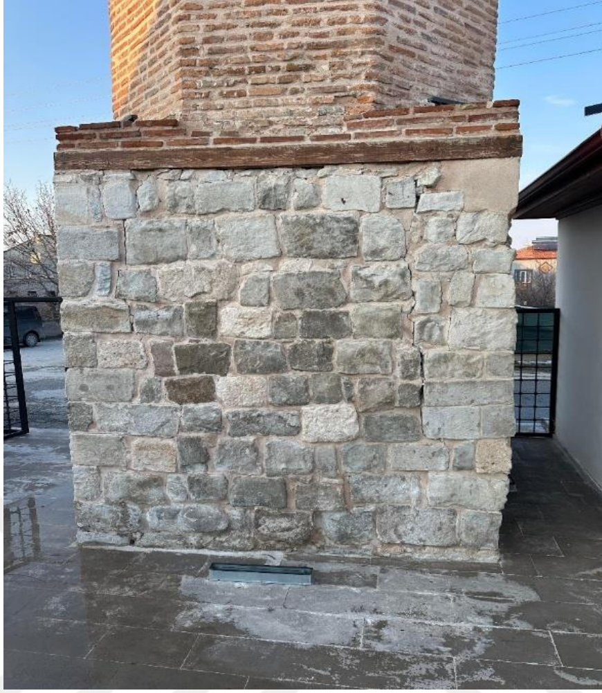
Şekil 11: Melik Sunullah Camii Minaresi'nin Kahramanmaraş Depremi Sonrası Fotoğrafı
