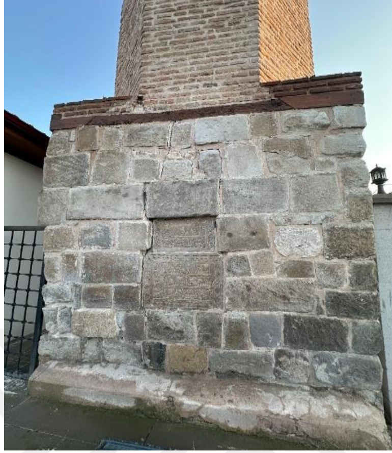
Şekil 9: Melik Sunullah Camii Minaresi'nin Kahramanmaraş Depremi Sonrası Fotoğrafı
