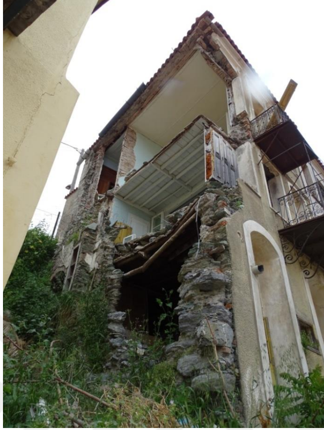
Şekil 3.47 Plomari’de 2017 depremi sonrası duvarı yıkılan konut yapısı (Kişisel arşiv, 2019)
