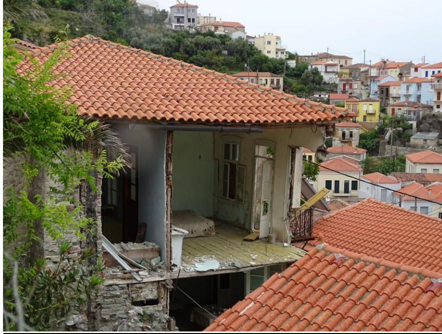
Şekil 3. 48 Plomari’de duvarı yıkılmış bir konut yapısı (Kişisel arşiv, 2019)
