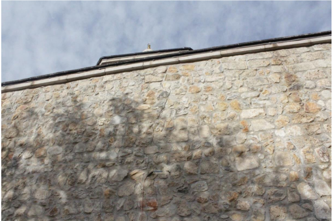
Şekil 2.6. Caminin dış duvarındaki çatlaklar.
