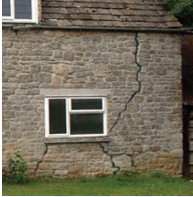
Şekil 3.2. Oturma çatlağı (URL-1).
