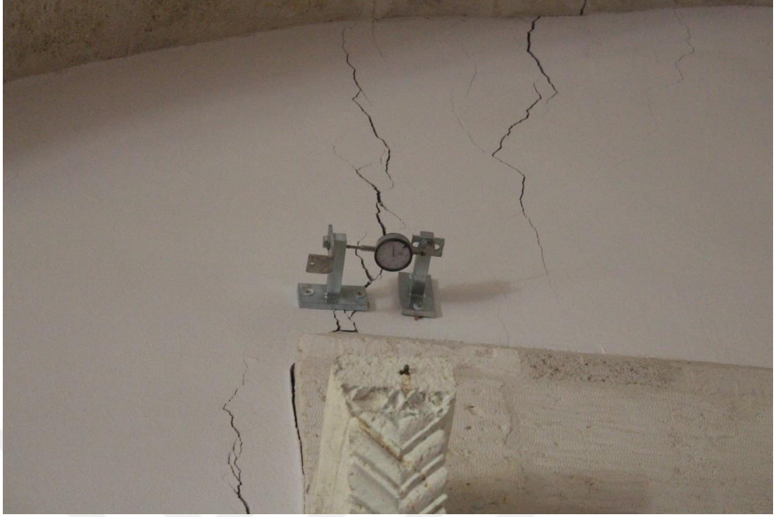
Şekil 2.7. Caminin iç duvarındaki çatlaklar.
