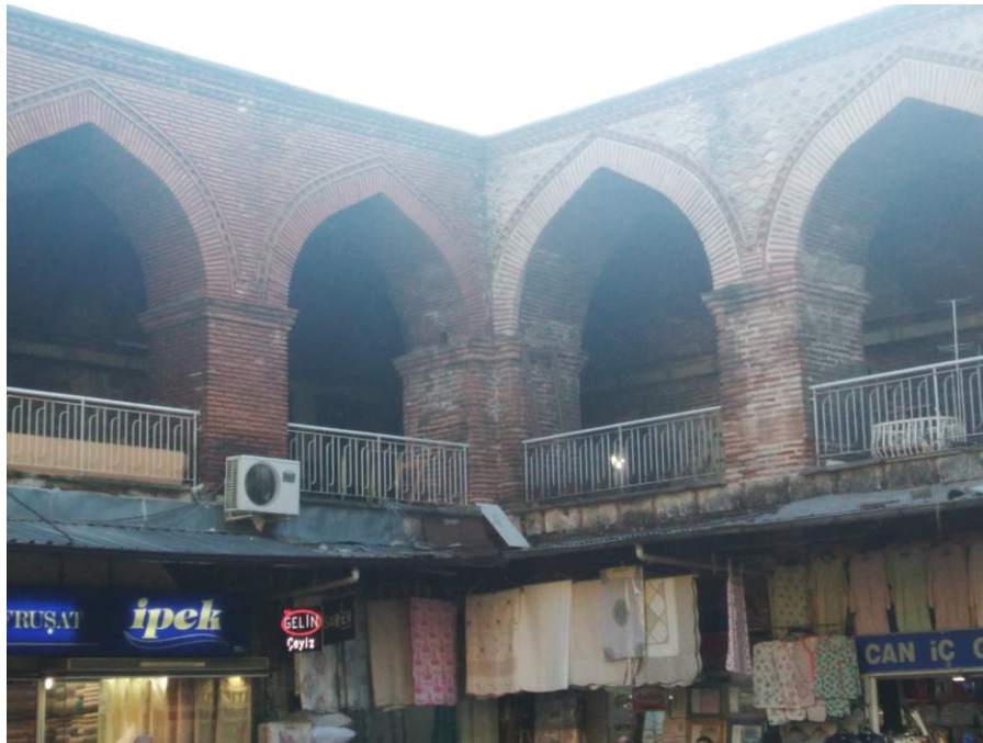
Şekil 115 Eski İpek Han, Üst Kat Avlu Cephesi Revak Duvarlarındaki Malzeme Farklılığı ( Hoş Ulusoy, 2021)
