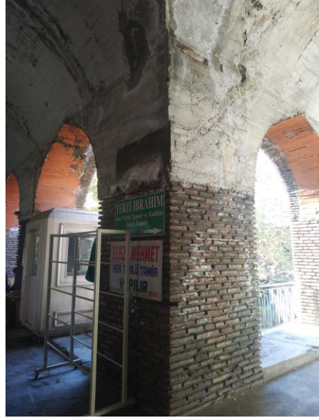
Şekil 123 Eski İpek Han Birinci Kat Duvarlarında Oluşan Bozulmalar (Hoş Ulusoy, 2021)
