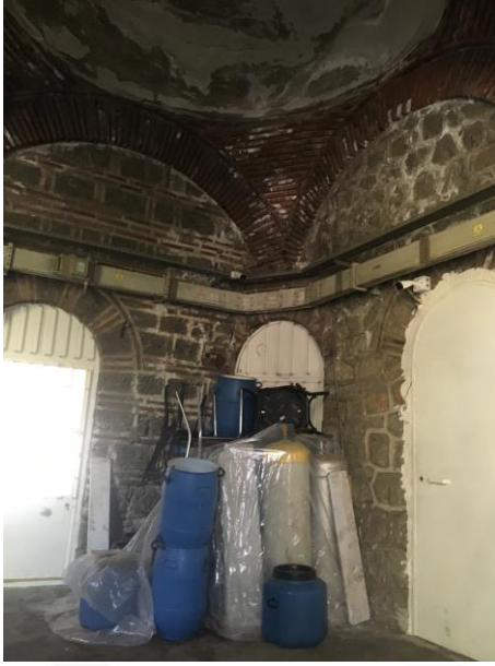
Şekil 124 Eski İpek Han Birinci Kat Duvarlarında Oluşan Bozulmalar (Hoş Ulusoy, 2021)
