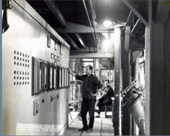
Şekil A: Elektrik kontrol papanolarının çalışır vaziyetteki görünümü Kaynak: SEKA arşiv döküasyon merkezi
