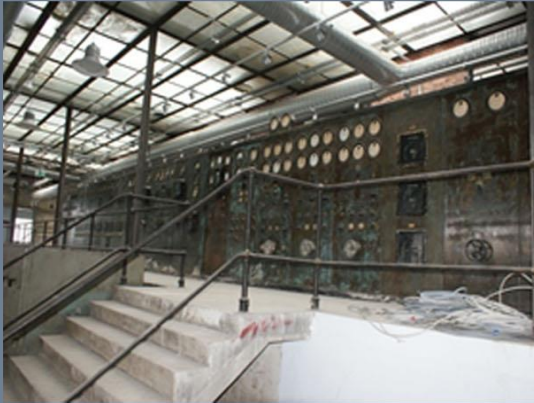
Şekil C : Elektrik kontrol panolarının restorasyonundan sonra yerinde korunarak sergilenmesi Kaynak: Çakır arşivi
