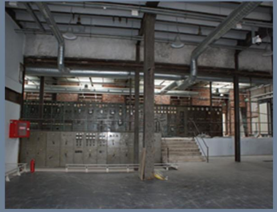
Şekil F : Enerji kontrol dairesinin korunarak yerinde sergilenmesi Kaynak: Çakır arşivi
