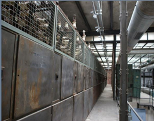
Şekil E : Elektrik kontrol panolarının yerinde korunarak sergilenmesi Kaynak: Çakır arşivi
