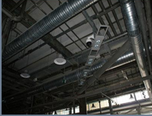
Şekil A: Havalandırma, aydınlatma ve güvenlik sisteminden görünüm Kaynak: Çakır arşivi
