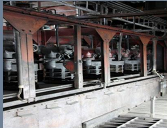
Şekil C: Tesiste bulunan elektrik türbünlerinin yerinde korunması Kaynak: URL 41
